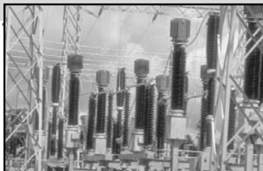
© ACIDI-CIDA (Kenya). Lignes électriques.
